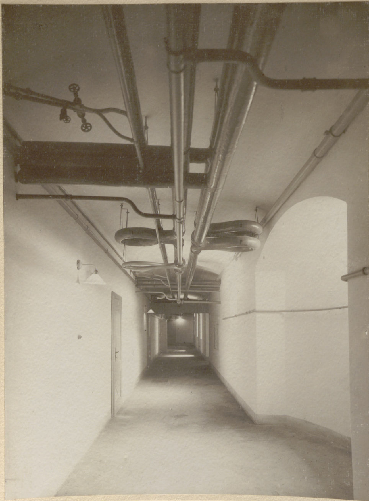
Rohrleitung im Soulerain, für sämtliche Gruppen.
